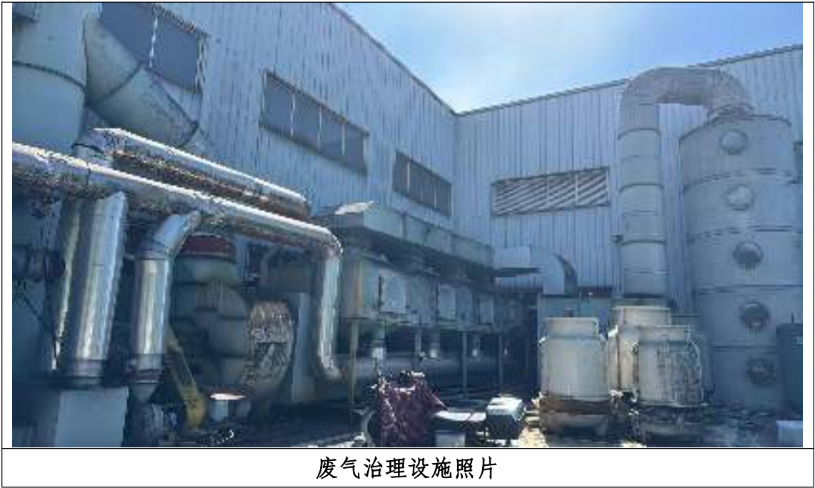
图 4-4 废气处理设施照片
